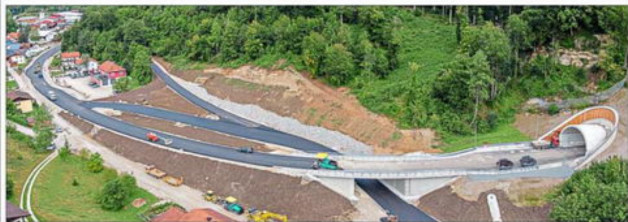
Am Westportal des Aubergtunnels wurde in den vergangenen Tagen die Asphaltdecke aufgebracht. Ab 22. September soll der Verkehr über die Straße, die unter der Tunnelzufahrt hindurchführt, wieder in Richtung Altmarkt fließen. – Foto: Georg Unterhauer/www.luftbild-traunstein.de
