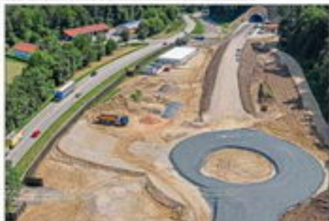
Einzelteil im Rahmen ist ein Teil der Umlenkung des Tunnel-Drains. Die Umlenkung wird im Rahmen der Baumaßnahmen erstellt.
